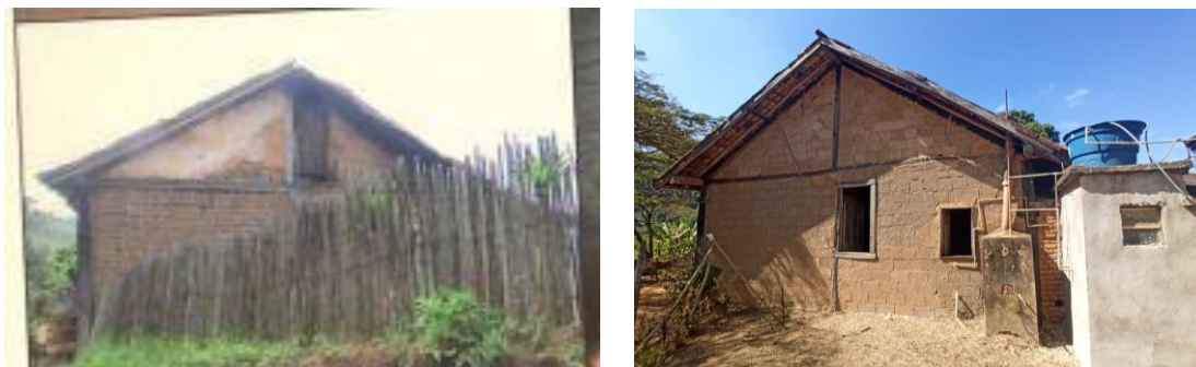
Figura 11 - A - Vista lateral direita da Fazenda Limeira com detalhes da parede de pau-a-pique em 2006; B - Vista lateral direita da Fazenda Limeira substituído por alvenaria
