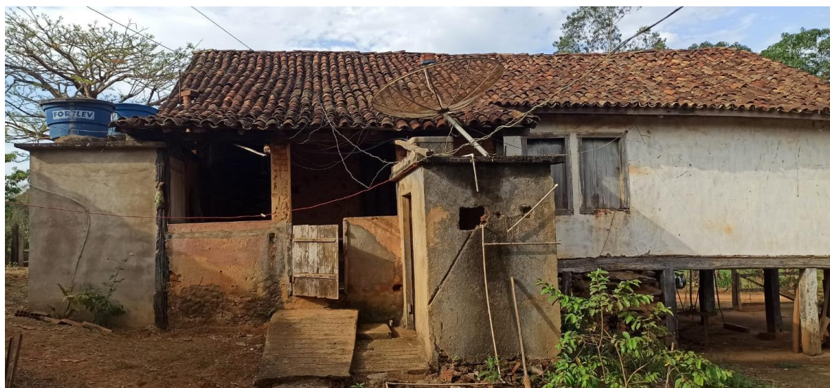
Figura 12 - Vista dos fundos da Fazenda Limeira com detalhes dos espaços acrescentados na edificação
