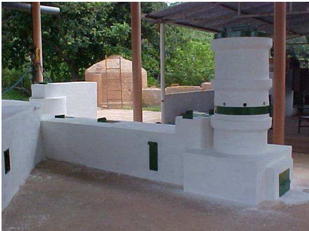
Figura 24: Sistema gerador de calor pronto para teste.
