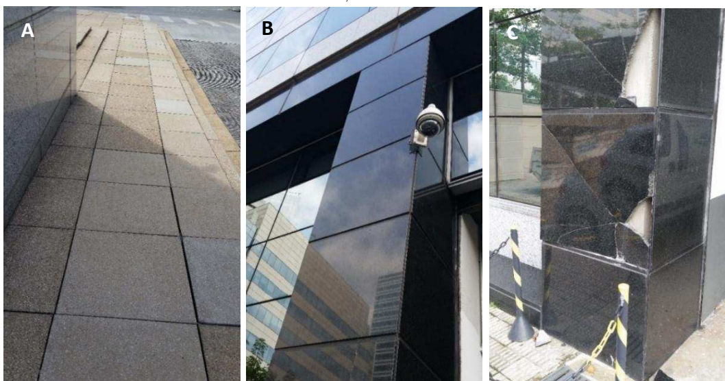
Figura 35: Detalhes externos do edifício. A: Calçadas com piso elevado. B: Câmeras de segurança externas. C: Placas soltas na fachada, já sinalizadas para manutenção. Fonte: acervo autora, em 16 de fevereiro de 2016.
