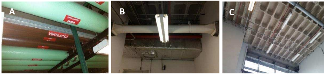
Figura 34: Cobertura da Garagem. Subsolo 01 da Torre B, Marble Tower. A: Identificação dos dutos. B: Dutos sob a laje da garagem. C: Laje protendida aparente. Fonte: acervo autora, em 16 de fevereiro de 2016.
