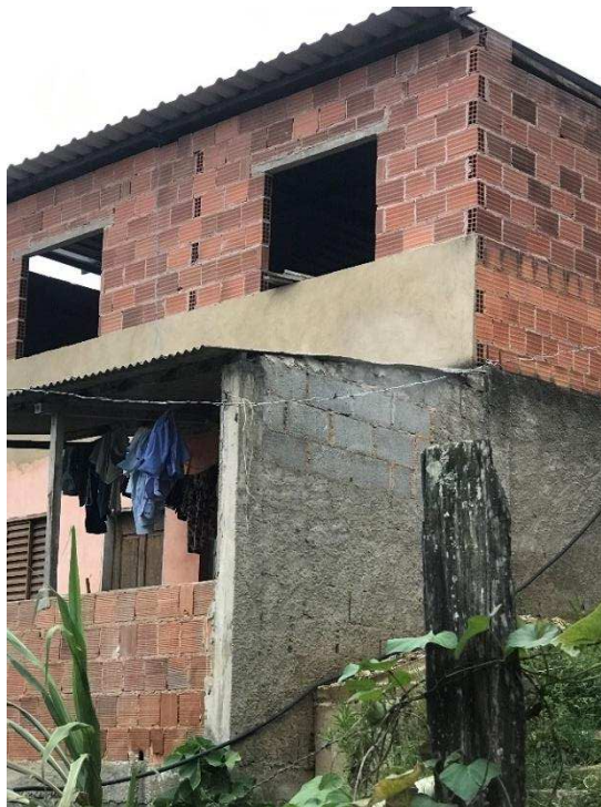
Figura 15 – Edificação sem sistema estrutural
