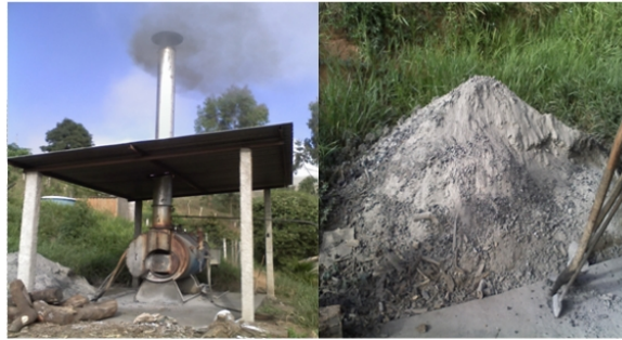
Figura 2 – Caldeira do laticínio e depósito de cinzas.
