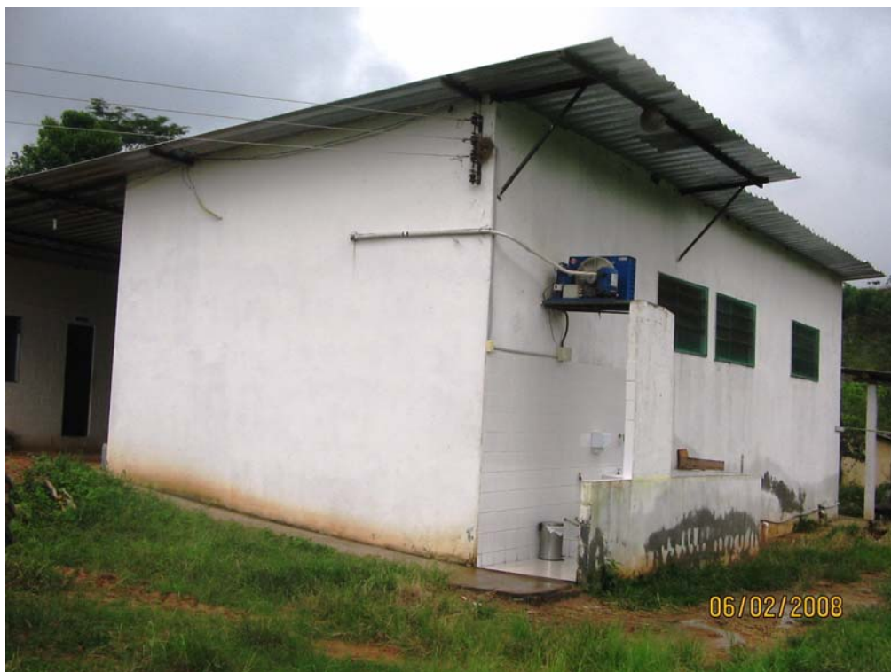
Figura 8 – Fábrica de laticínios que teve o registro cancelado por não fazer reforma/ampliação, mas que no ano de 2008 conseguiu novo registro.
