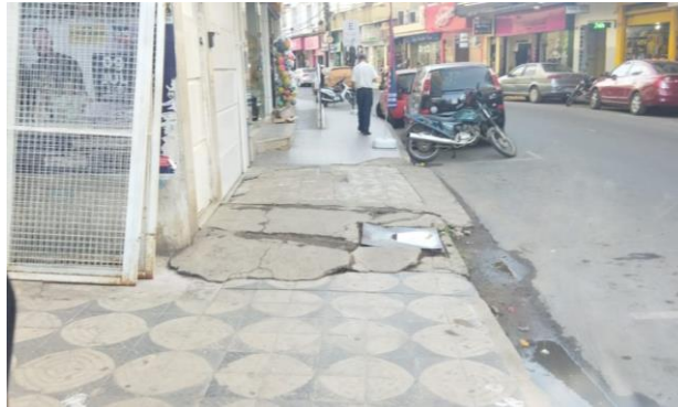
Figura 37 – Má qualidade da pavimentação: trecho 4
