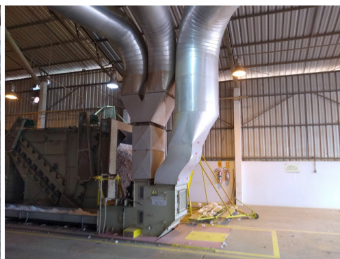
Figura 237 - Ao fundo, a descompactadora, com os dois conjuntos de batedores de pinos acabando de processar um fardão. Na frente, a esteira com o algodão descompactado sendo encaminhado à caixa hot box , que tem uma mistura de ar frio com o quente para dar um choque de secagem. UP Ribeiro do Céu
