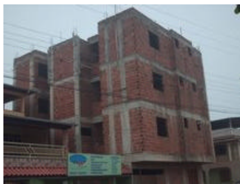
Foto 11 – Um dos prédios do município em fase de construção, situado à Rua São Sebastião de Ipaba, centro (2007).
