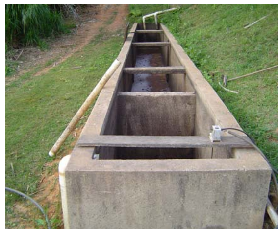
Figura 5 – Vista frontal do tanque de decantação
