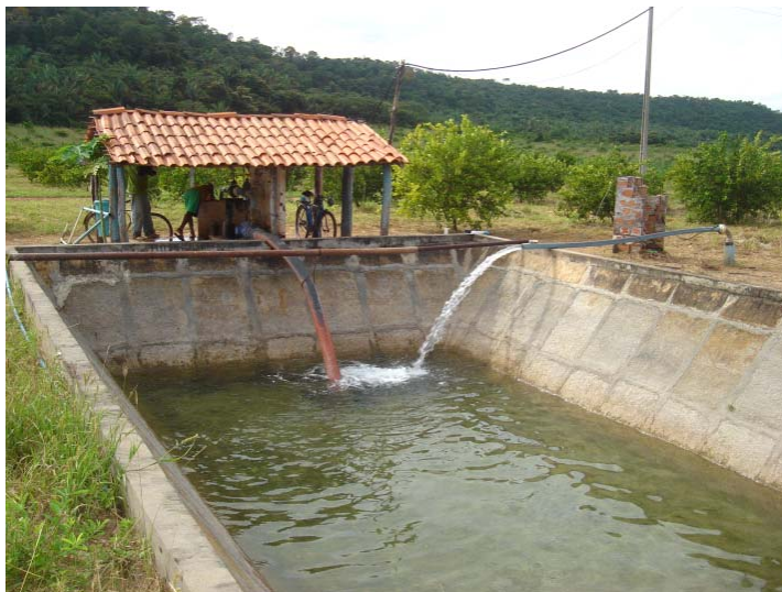
Figura 9. Detalhes do poço tubular, do reservatório de derivação e do sistema de bombeamento utilizado no experimento.
