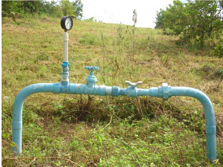
Figura 8. Detalhe do cavalete na entrada da área experimental, com manômetro e registro, instalado no início da linha de derivação.
