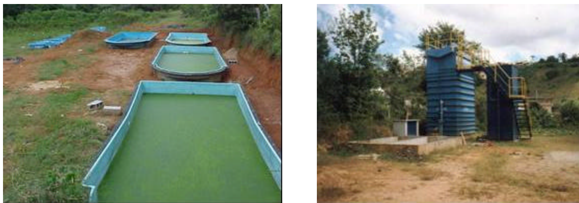
Figura 1 – Vista do sistema de tratamento de esgotos: reator UASB + biofiltro aerado submerso e lagoas de polimento
