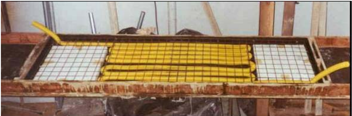
Figura 3 - Interior das placas utilizadas para o resfriamento.
