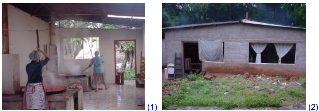
Figura 16 – Pendências da reforma da Agroindústria 1: (1) Vista interna da área de processamento; (2) Vistas externa e lateral da mesma área, Junho de 2005.
